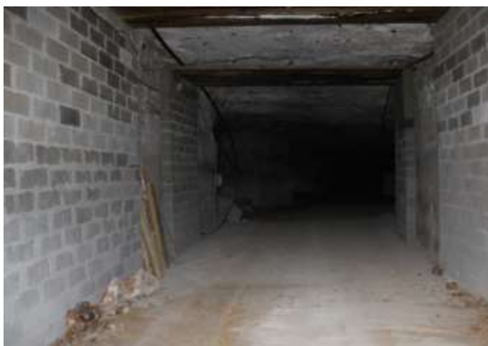
Photographie 4 : Couloir muré
