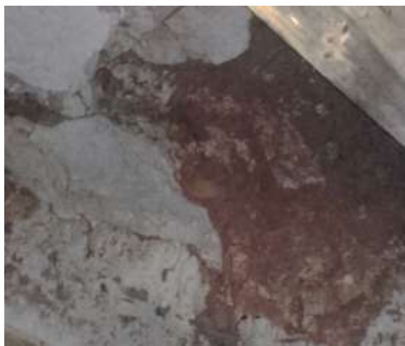
Photographie 5 : Fracturation apparente du toit
