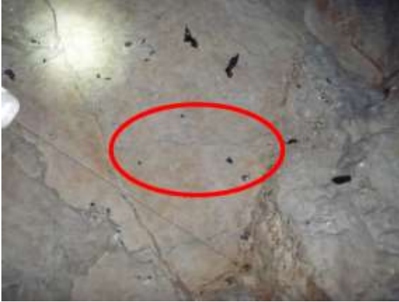
Photographie 11 : Fissure mécanique au toit de la carrière
