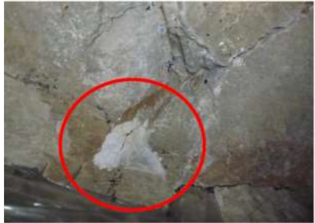
Photographie 16 : Zone de départ de la chute de toit
