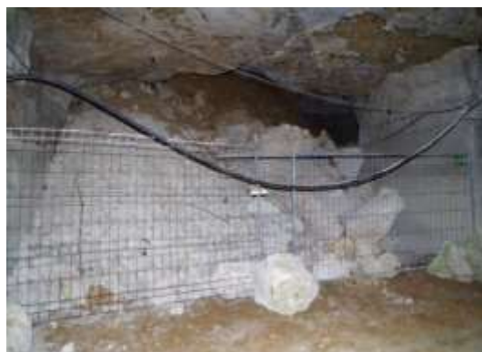
Photographie 5 : Remblais dans la galerie Sud en limite de la zone d'exploitation de la société T.E.R.H.
