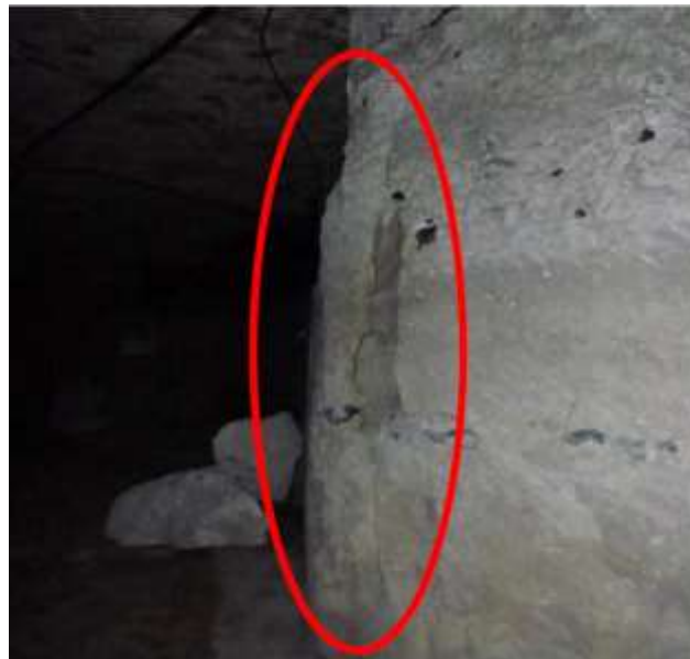
Photographie 18 : Autre écaillage d'un parement de pilier
