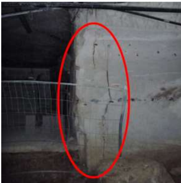
Photographie 17 : Ecaillage d'un parement de pilier
