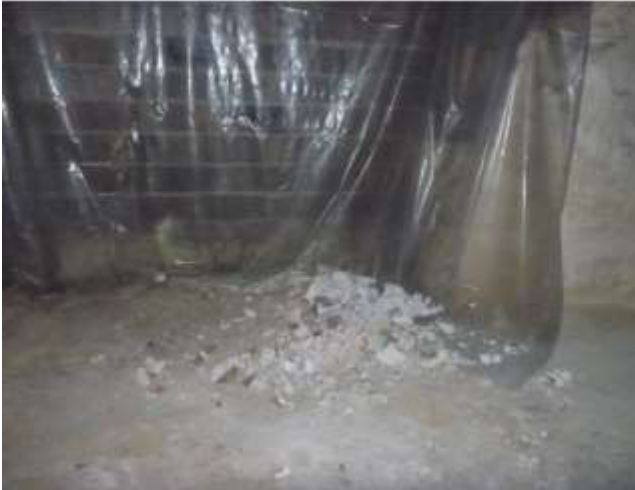
Photographie 15 : Petite chute de toit récente
