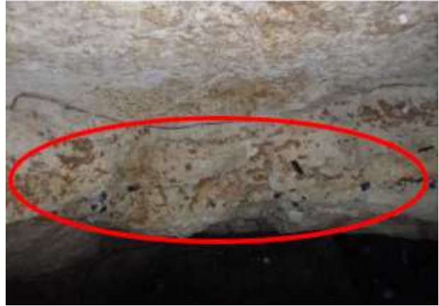
Photographie 12 : Décollement du premier banc de toit
