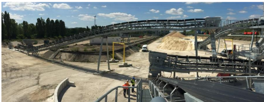
Figure 5 : exemple de tête de convoyeur (Photo : Techmi)
