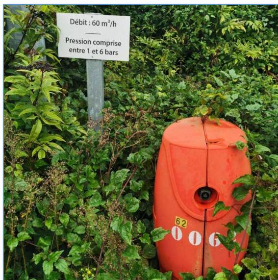
Fig. 65 : Borne incendie sur le site
