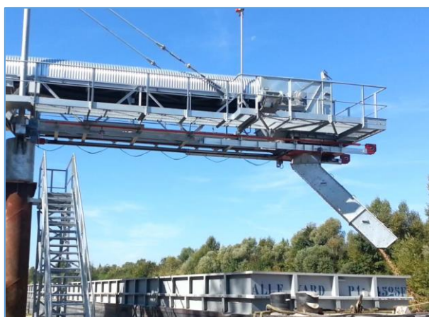
Fig. 14 : Goulotte de jetée articulée non translatable (Photo : Techmi)
