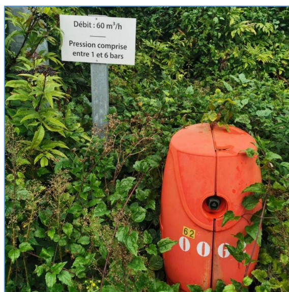
Fig. 9 : Borne incendie sur le site
