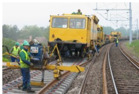
Longs Rails soudés sur traverses béton
