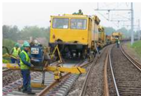
Longs Rails soudés sur traverses béton
