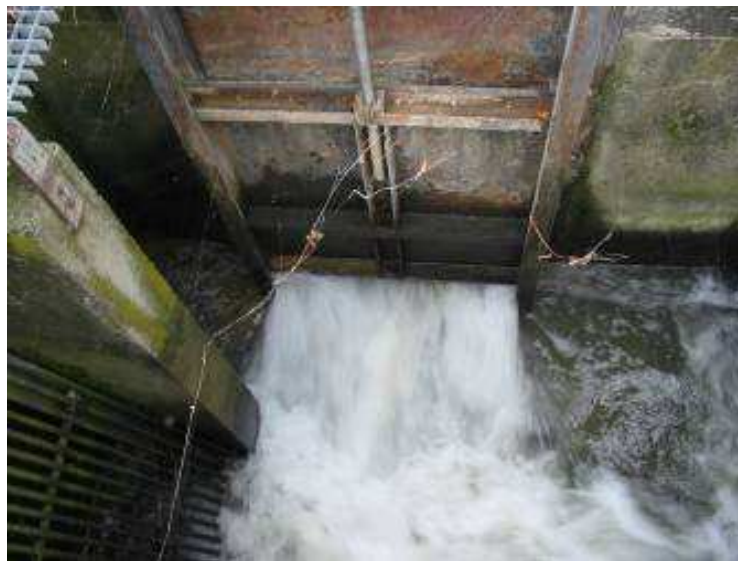
Figure 14 : Exemple d'écoulement sous une vanne de fond
